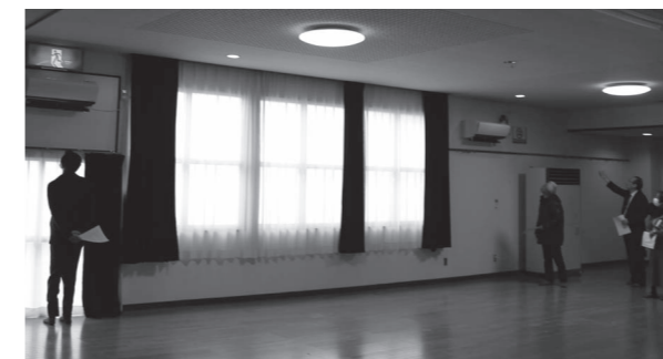
西富公民館の集会室に新設されたエアコン
