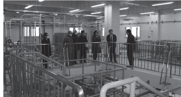
上佐呂間地域と若里地区の一部の水道を賄う栃木浄水場
