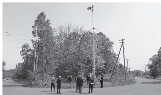
津波対策として設置した若里拡声子局
