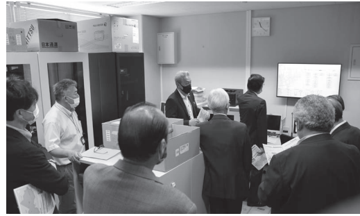
電算室にて防災行政無線システムの説明
