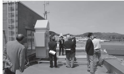
庁舎屋上の停電用発電設備
